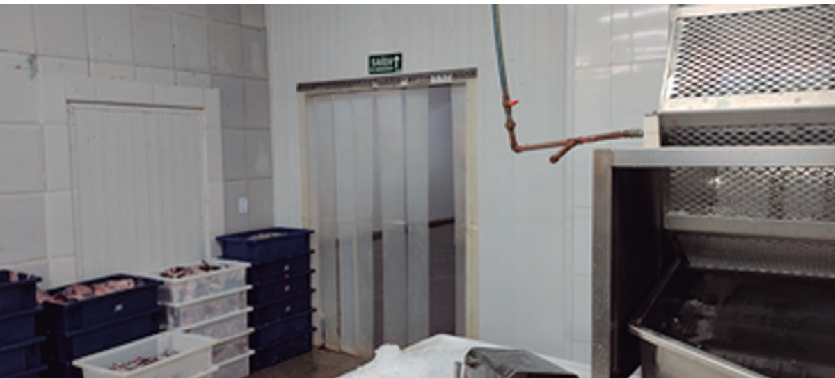
FIGURA 7 Porta de passagem construída de forma errada, ligando a área suja com a área limpa e permitindo a passagem de pessoas e material
