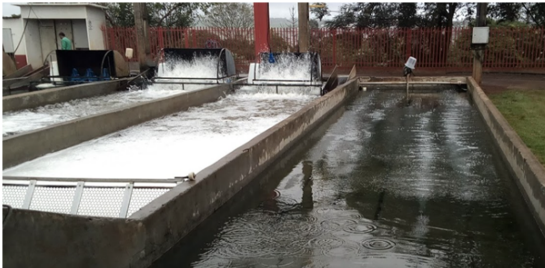
FIGURA 2.4 - Tanques de recepção/depuração no frigorífico com aeradores
