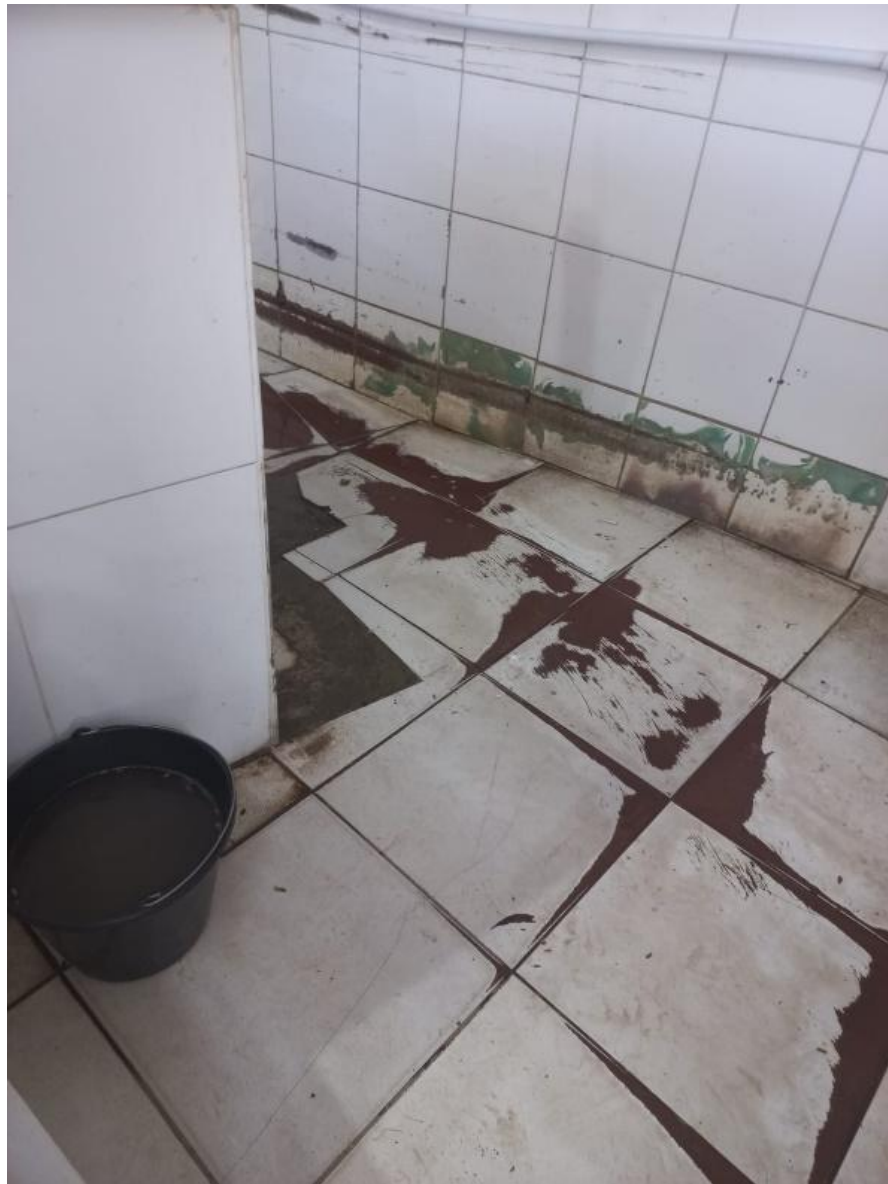
Figura 1. Azulejos de pisos e paredes mantidos em mau estado de conservação em um estabelecimento varejista de pescado. Também, nota-se a presença de uma água turva no balde, a qual era utilizada em processos de limpeza. Fonte: acervo do autor
