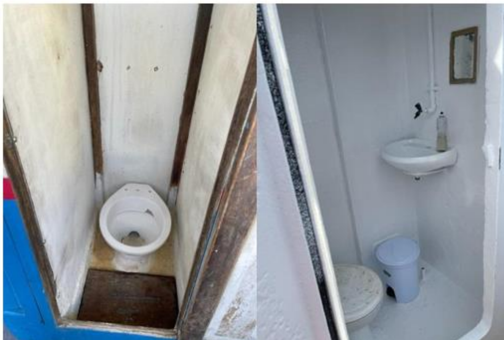
Figura 3: Banheiro da embarcação antes e depois das adequações à Portaria SAP – MAPA 310/2020. Foto: Juliana de Medeiros.
